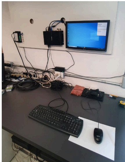
Figura 1. Tablero de control para la automatización de procesos dentro del contenedor. En esta fotografía aún no se muestra la fuente de poder y el adquisidor de parámetros internos del contenedor para vigilar la operación de todos los equipos de manera remota.
